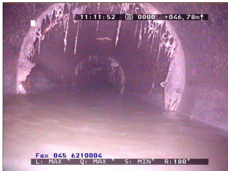
Figura 8 : Collettore Basso Lago – Intrusione di radici in corrispondenza dei giunti.
